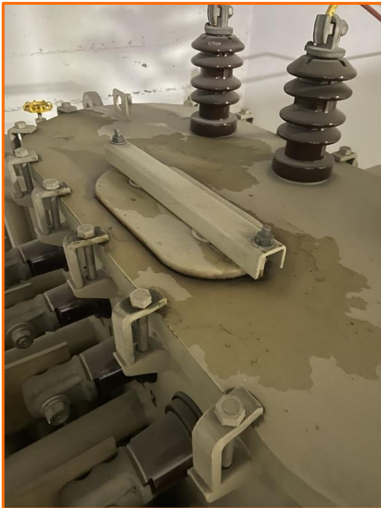
18 – Indícios de vazamento de óleo isolante sobre a tampa do transformador.
