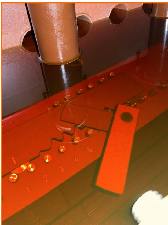
20 – Comutação do transformador (posição 01: 13,8 kV).
