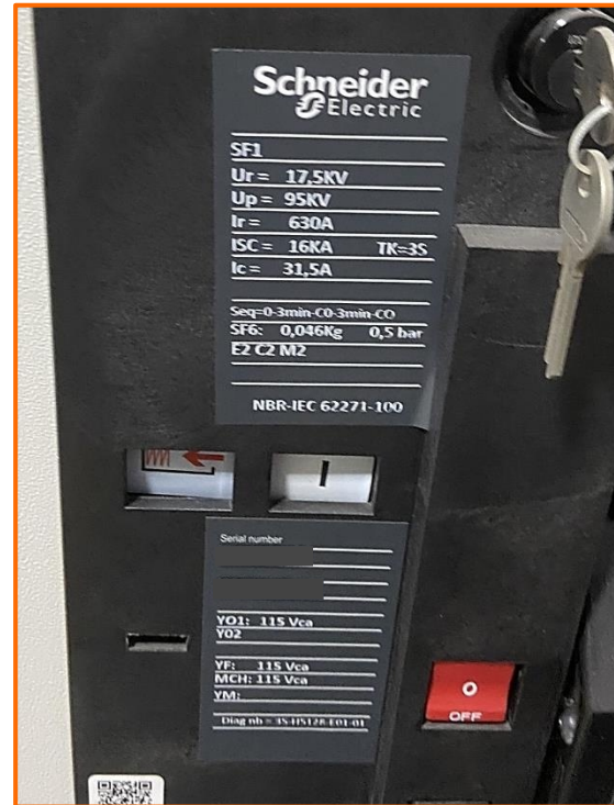
8 – Placa de identificação do disjuntor de média tensão.
