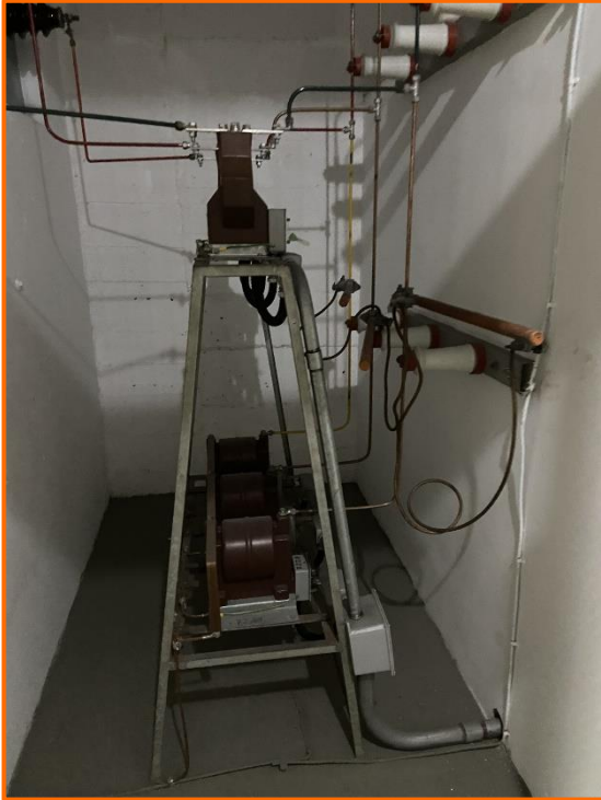
4 – Transformadores de medição da Celesc.
