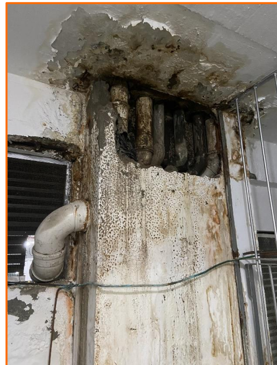
31 – Parede da subestação com alto grau de infiltração.
