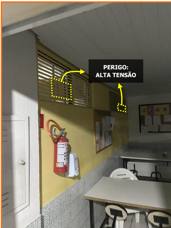
30 – Não há placas de advertência nas janelas da subestação.
