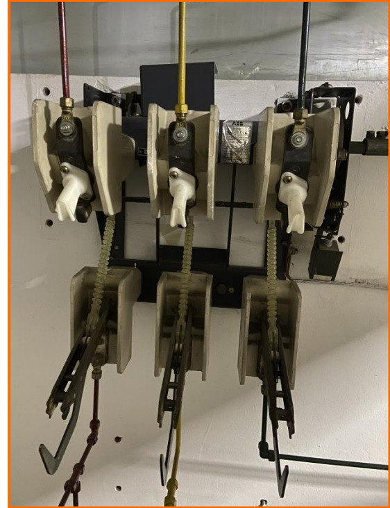
5 – Chave seccionadora junto ao disjuntor de média tensão.
