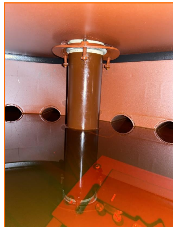
21 – Nível de óleo isolante no transformador (normal).
