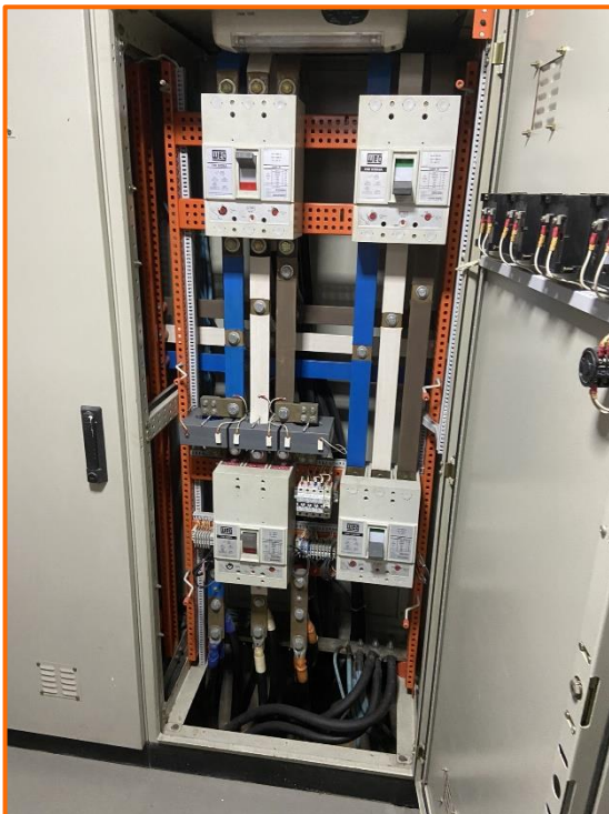
23 – Quadro geral de baixa tensão (QGBT) sem DPS.
