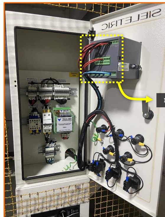
10 – Quadro de comando do disjuntor aberto para verificação.
