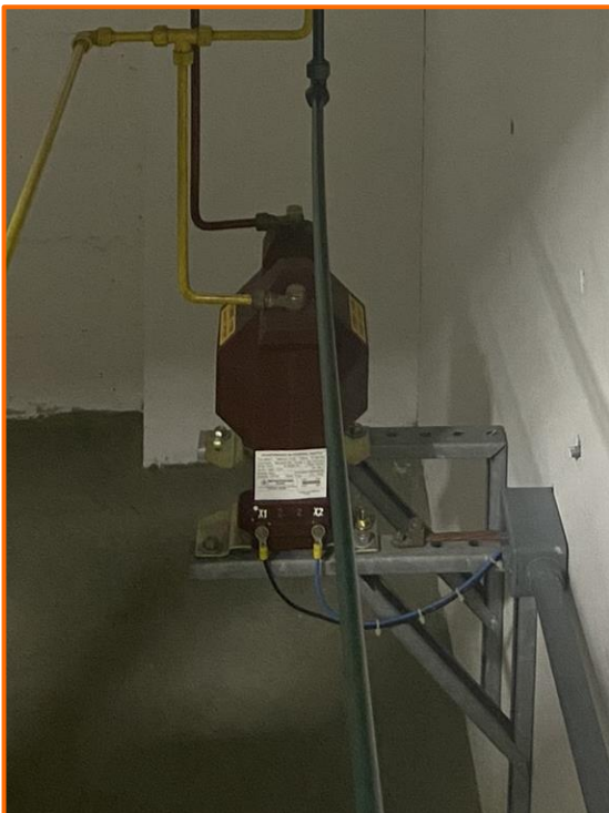
6 – Transformador de potencial (TP) junto ao disjuntor de média tensão (13.800 / 115 V).
