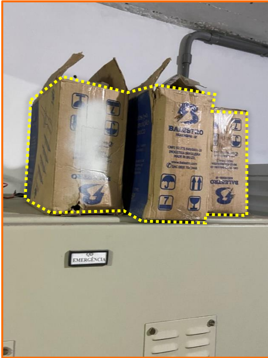
28 – Há três para-raios alocados sobre o quadro QD Emergência.
