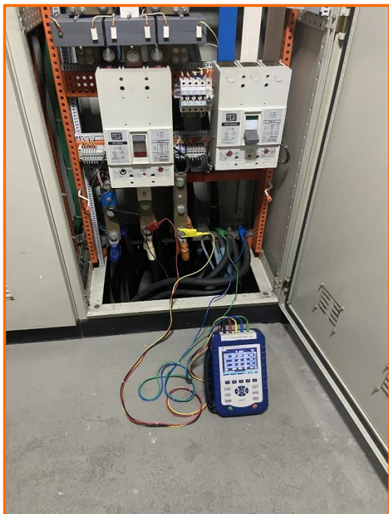
25 – Análise de energia sendo realizada junto ao QGBT.
