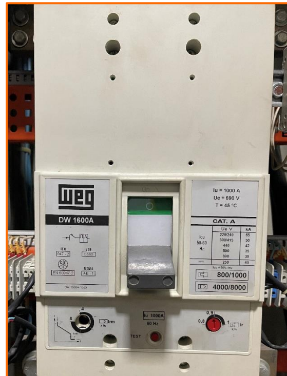
24 – Disjuntor geral de baixa tensão (ajustado em 900 A).
