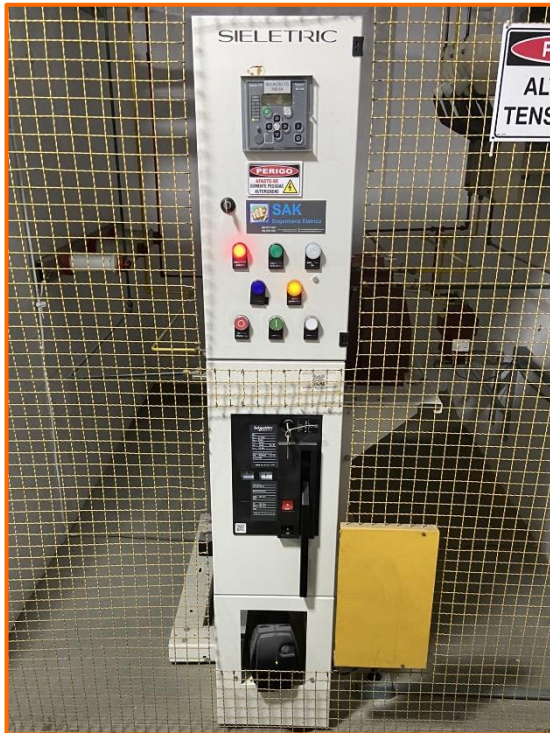
7 – Disjuntor de média tensão.
