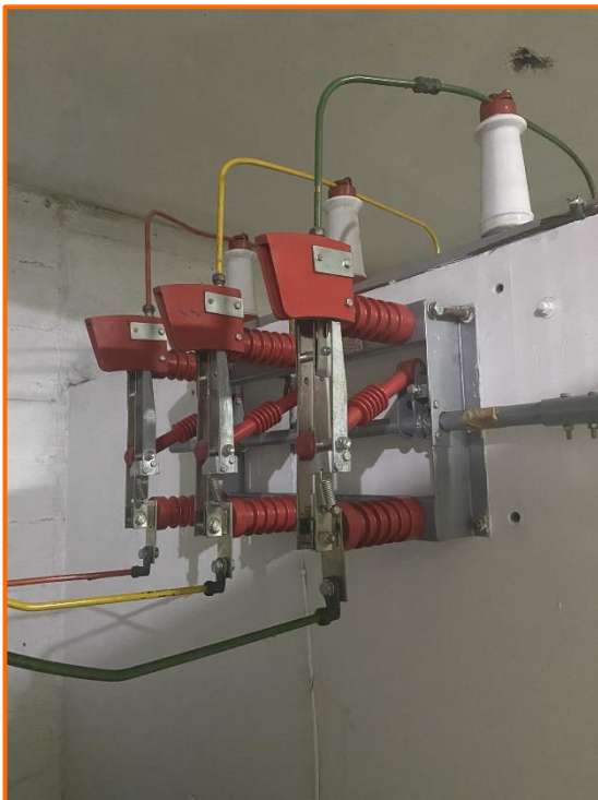
16 – Chave seccionadora junto ao transformador.
