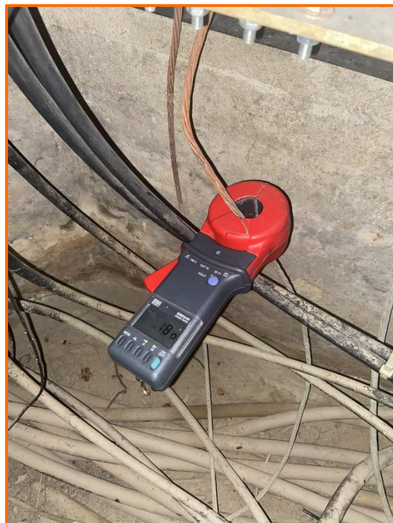
26 – Medição da resistência ôhmica de laço de terra (0,18 Ω).
